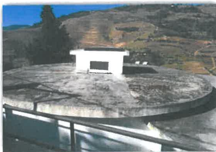
FOTO 2 - RESERVATÓRIO DE COVELINHAS
