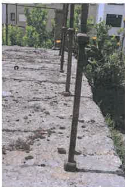
Fot. 29 Elementos metálicos oxidados
