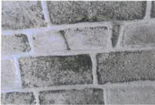
Fot. 21 Preenchimento excessivo e generalizado de juntas com argamassas dissonantes
