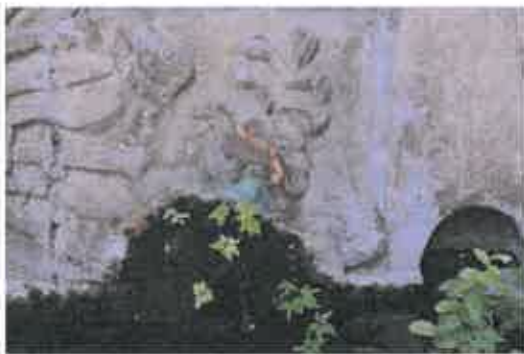
Fot. 19 Manchas resultantes da alteração de vestígios metálicos existentes
