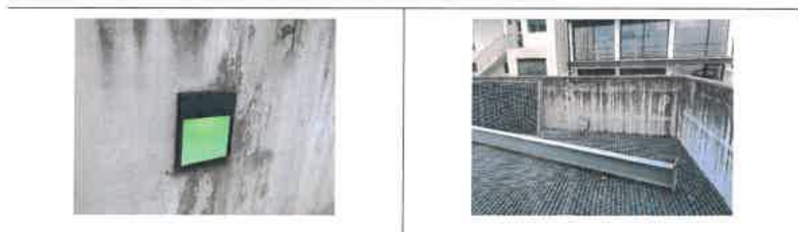
Figura 2 – Fotos gerais do sistema de iluminação exterior
