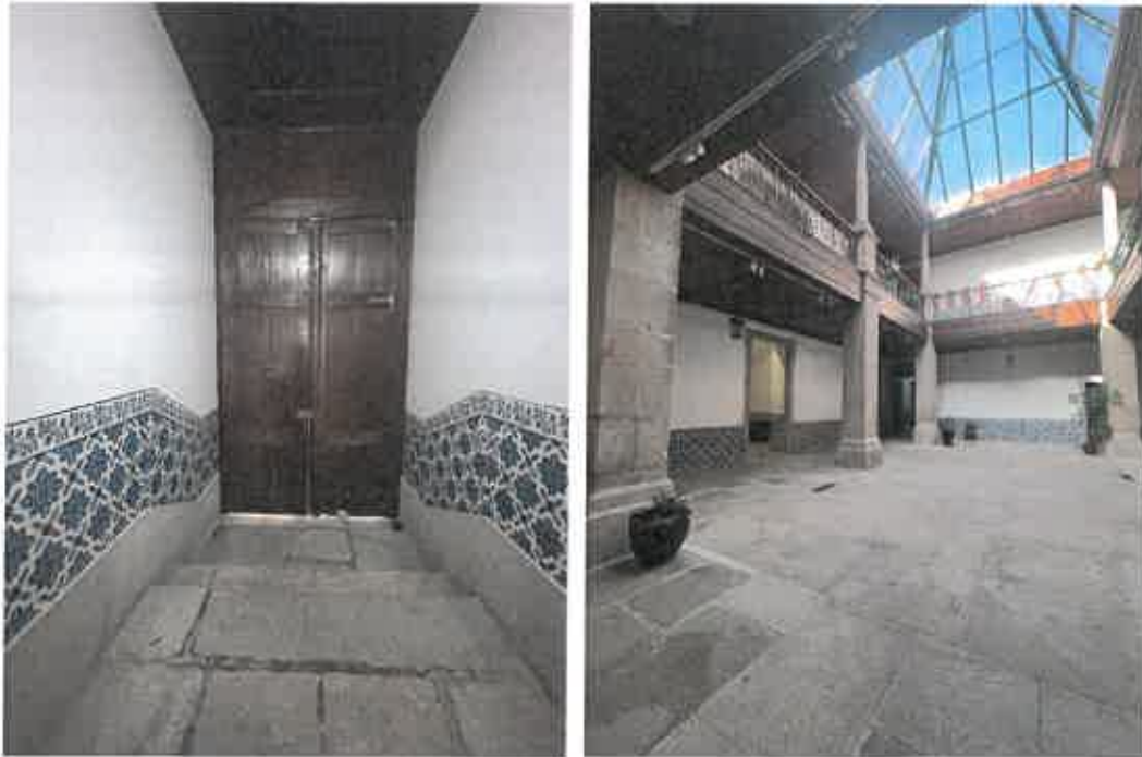
Fig 3 e 4 | Acesso aos claustros - a necessitar de intervenção para melhoria das acessibilidades
