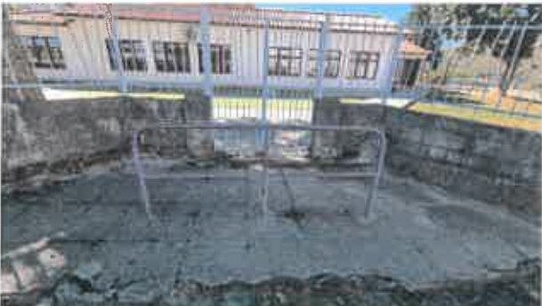
Fig 3 | Acesso desde via pública - a necessitar de intervenção para melhoria das acessibilidades
