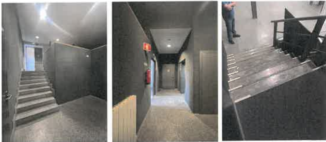
Fig 4, 5 e 6 | Acesso ao palco do grande auditório, interior - a necessitar de intervenção para melhoria das acessibilidades
