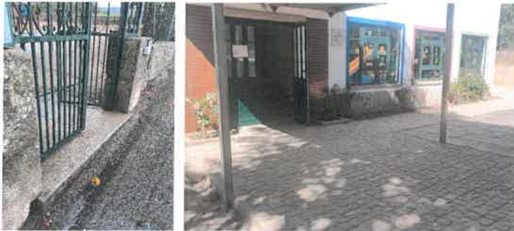
Fig 2 e 3| Acessos desde via pública - a necessitar de intervenção para melhoria das acessibilidades
