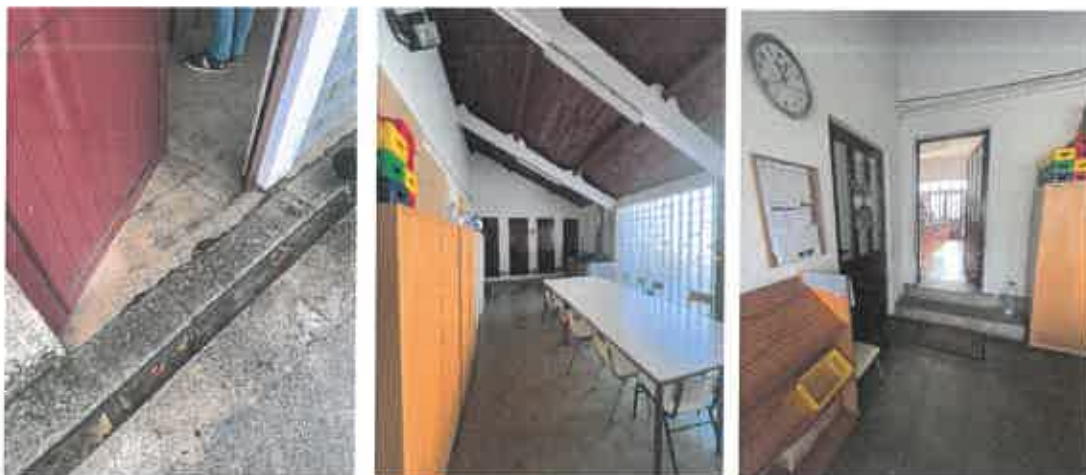
Fig 4, 5 e 6 | Acessos pela entrada principal e desníveis interiores - a necessitar de intervenção para melhoria das acessibilidades
