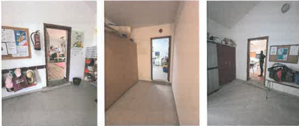
Fig 6, 7 e 8 | Acessos aos diversos espaços da escola - a necessitar de intervenção para melhoria das acessibilidades
