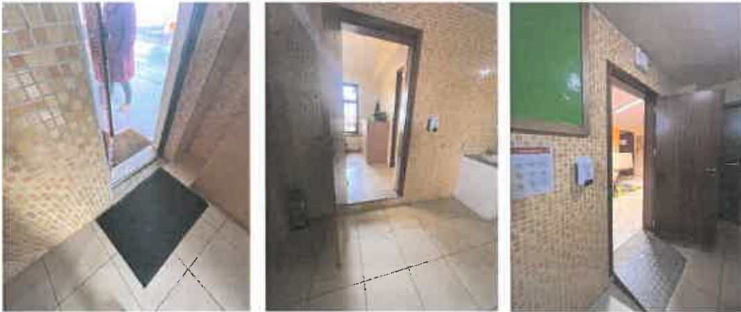
Fig 5, 6 e 7 | Acessos interiores - a necessitar de intervenção para melhoria das acessibilidades
