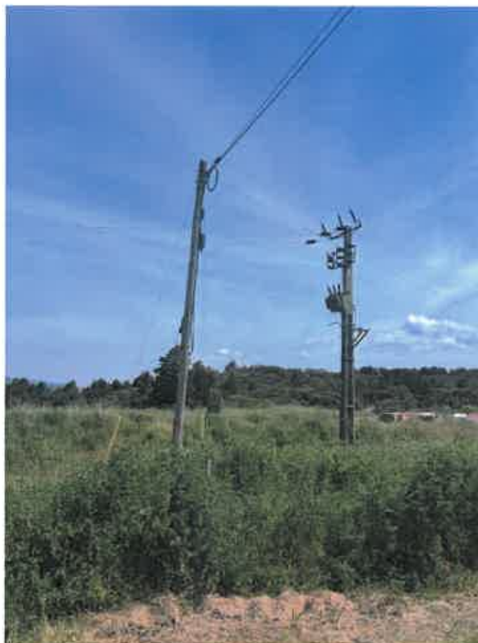
Fotografia 7 - PT aéreo a alterar e rede de comunicações a alterar.
