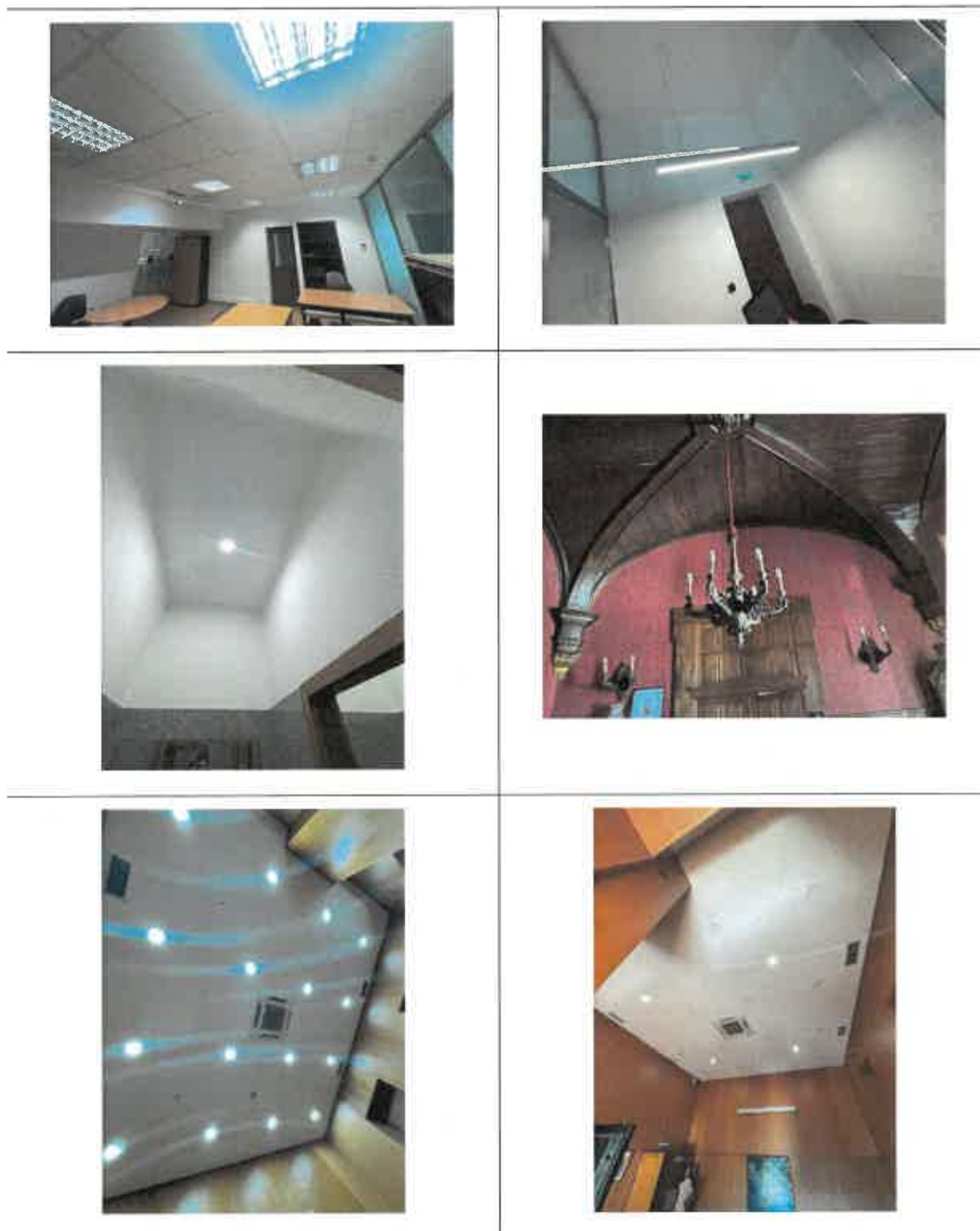
Figura 1 – Fotos gerais do sistema de iluminação interior
