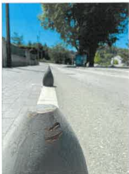
Fig. 3 – Dissuasor (com espigão) danificado após embate de veículo.
