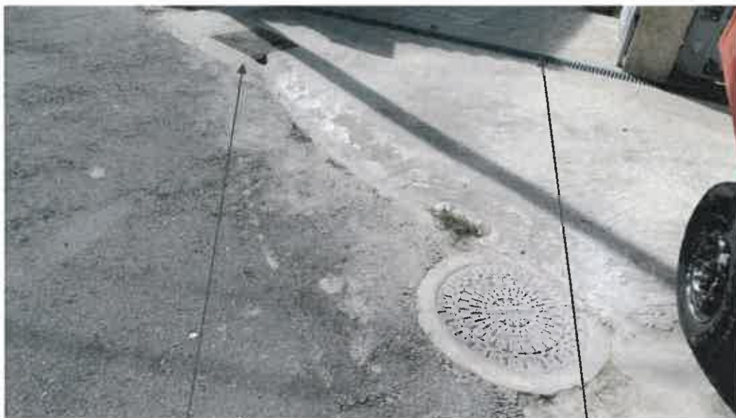
Grela para receção de águas pluviais colocada pelo senhor Américo “Gateira” existente
